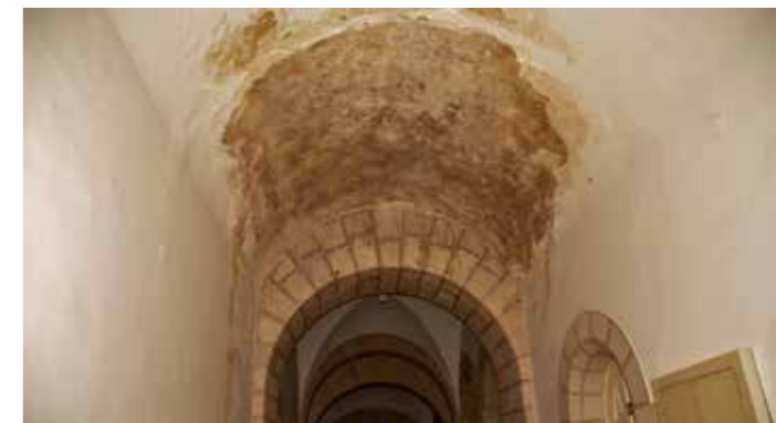
Die marode Wasser-Installation verursacht im Gewölbe des Wohntraktes der Mönche (1. Stockwerk) massive Schäden.
