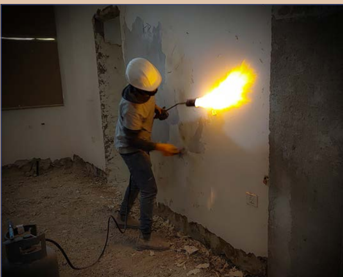
Fast alle Wände und Decken im ganzen Haus werden derzeit mit Flammenwerfern behandelt, um die alten Farbschichten (oft eines ganzen Jahrhunderts) zu entfernen.
