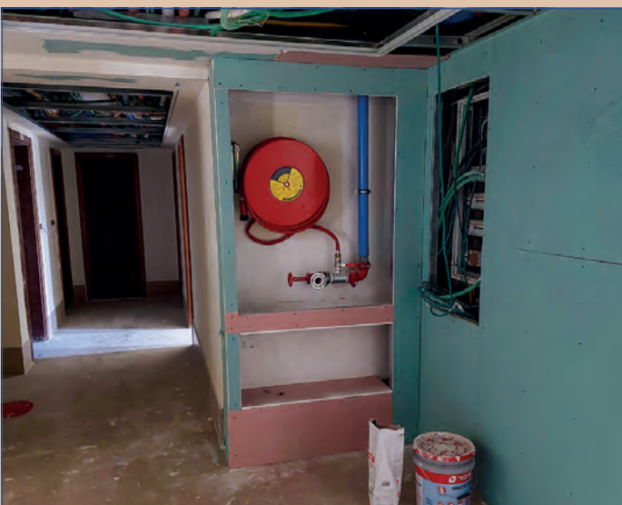
Immer mehr Strom- und Wassersysteme verschwinden nun in neuen Wandteilen aus Gips: Es wird optisch also „ordentlicher“ (1. Januar).
