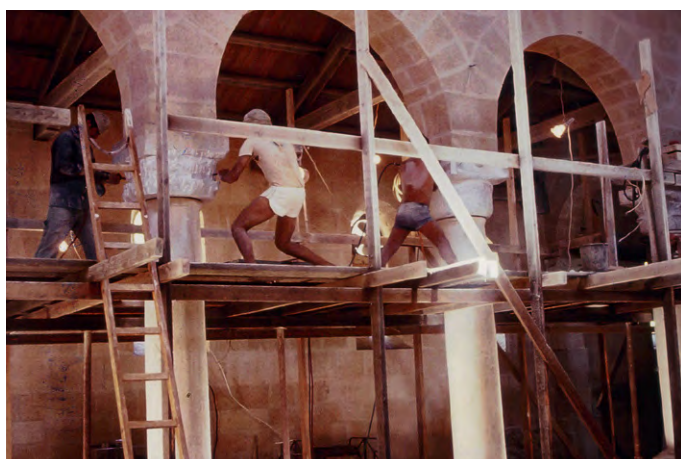
Ein besonderer Schritt der Arbeiten beim Neubau der Kirche, als die Kapitelle gestaltet werden.
