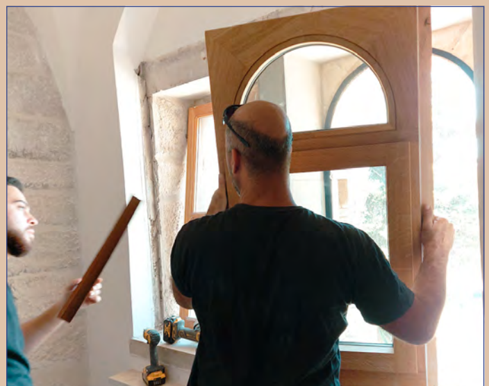
Unser Hausmeister Amjad hat den Spezialjob übernommen, die neuen Holz-Alu-Fenster aus Deutschland einzubauen (28. Oktober).
